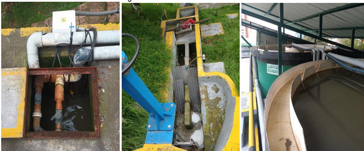
Imagen 1. PTAR HOMIL en funcionamiento
