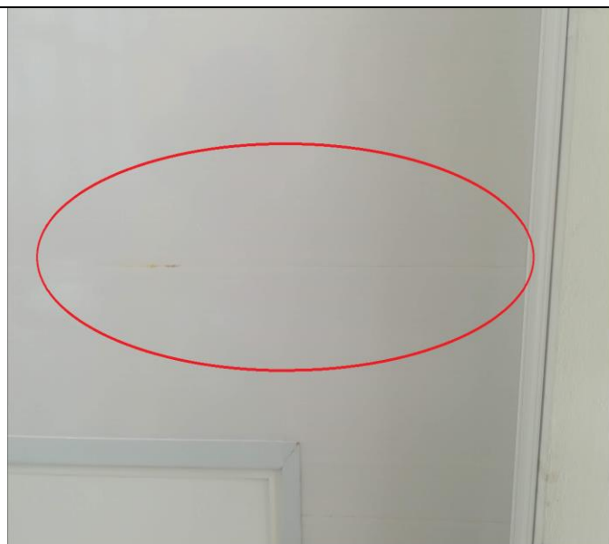
Registro fotográfico: láminas de PVC con filtraciones de agua lluvia en el área de archivo de hojas de vida de equipo biomédico.
